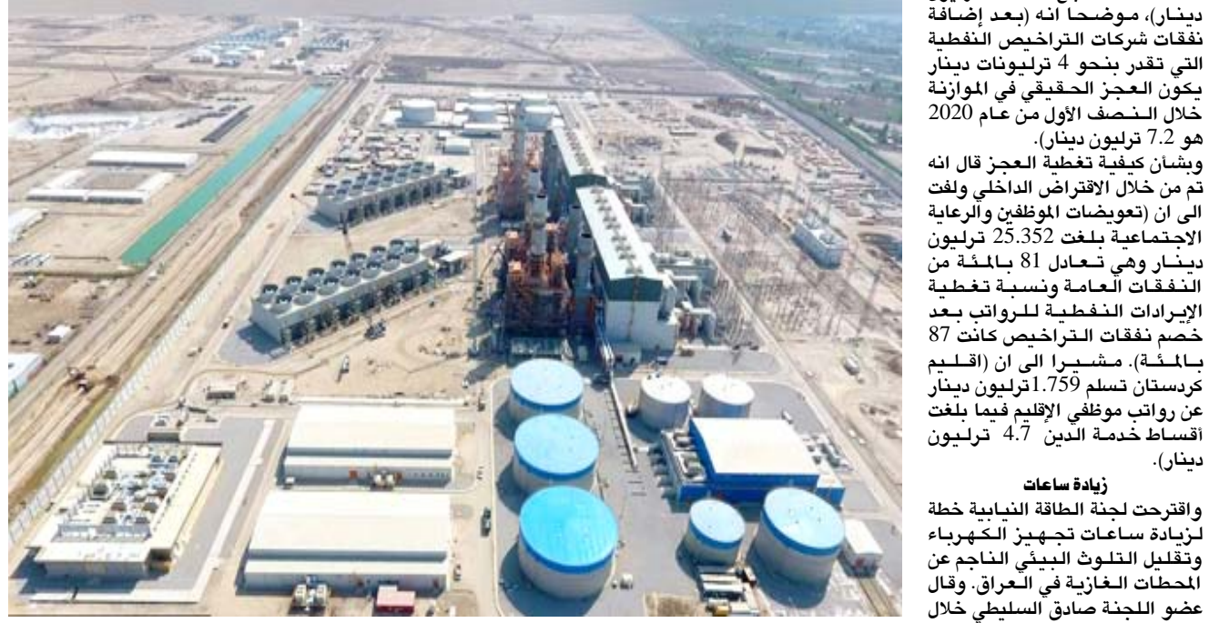
محطة : منظر علوي لمحطة توليد الطاقة الكهربائية في بسماية
