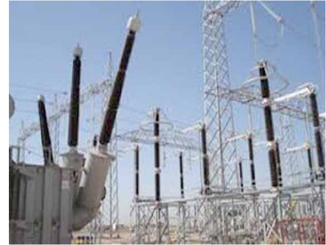
محطة توليد الكهرباء
