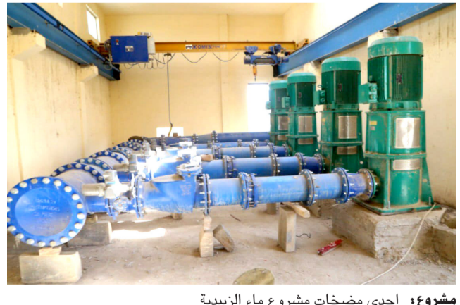
مشروع: احدى مضخات مشروع ماء الزبيدية
